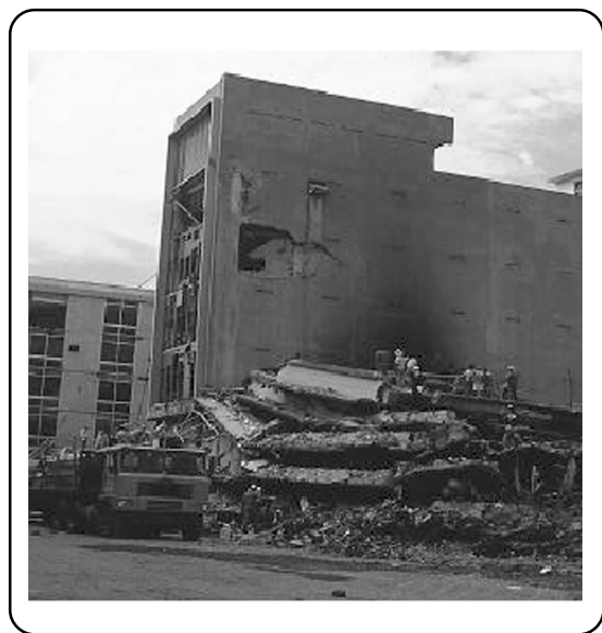
Foto: COLAPSO. Edificio Rubén Darío, Centro Histórico San Salvador. octubre 1986.
