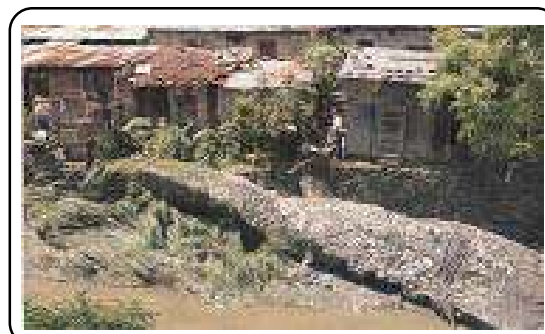
Foto: Muro cede ante tormenta El muro de contención no pudo contener la fuerza del agua y arremetió contra varias viviendas de la colonia Sánchez. Fuente: La Prensa Gráfica, Julio 20, 2004
