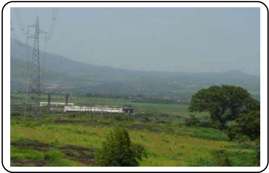
Fuente: PNOTD, 2003.CEL. Foto: Subestación Eléctrica Nejapa Power (Municipio de Nejapa)
