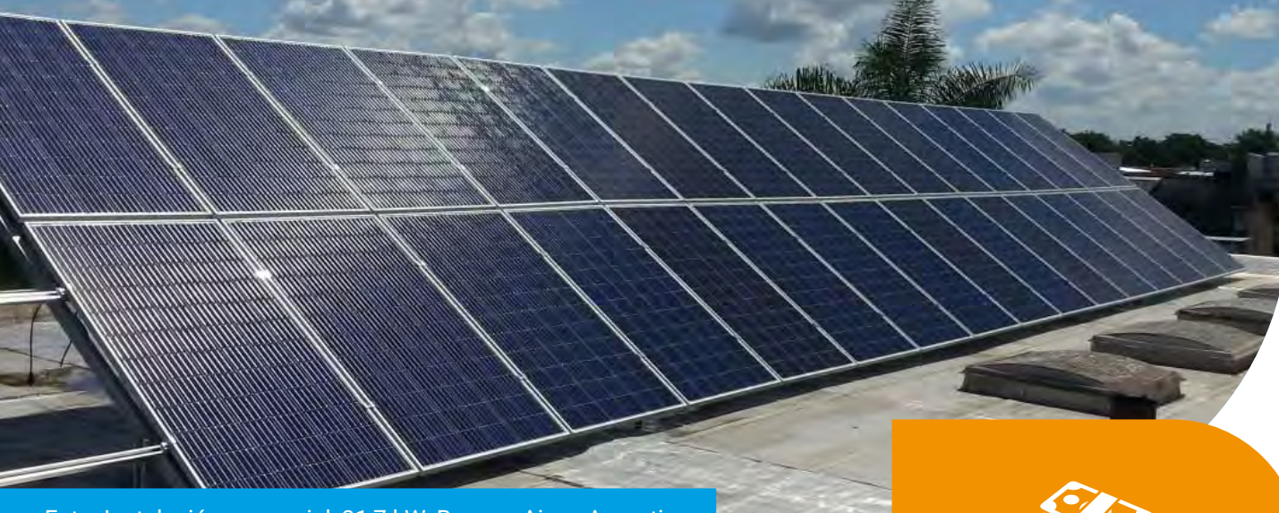
Foto: Instalación comercial, 31,7 kW. Buenos Aires, Argentina.
