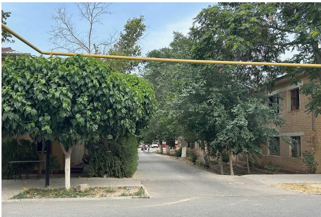
Желтые газовые трубы распространены в городских и пригородных районах Термеза © ЮНЕП
